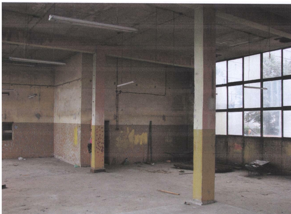
Fot. 2 Fragment pomieszczenia głównego wymiennikowni, Ekspertyza (...), BAUREN Renke Piotr, 2007.
