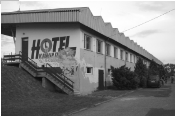
Budynek na stadionie Górnika Brzeszcze wymaga kosztownego remontu.
