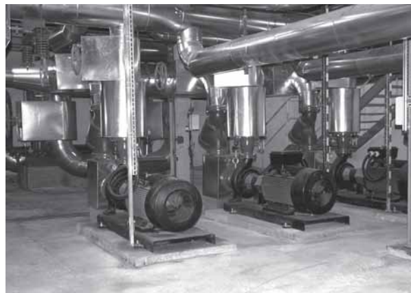
Zestaw pomp obiegowych Nadwiślańskiej Spółki Energetycznej.
