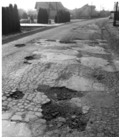
Ulica Przeczna jest drogą powiatową, ale o lokalnym zasięgu. Dlatego na kompleksowy remont póki co nie ma szans - mówią w Zarządzie Dróg Powiatowych.
