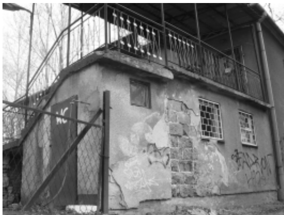
25 000 tys. złotych to zdecydowanie za mało, by budynek LKS Jawiszowice przywrócić do dobrego stanu.
