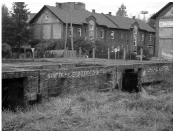
Fundamenty są niebezpieczne dla bawiących się w tym miejscu dzieci.
