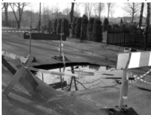
Awarie kanalizacji na ul. św. Wojciecha ciągną się od lat.
