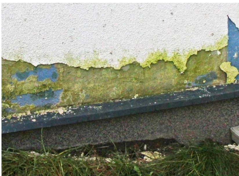
Fot.7.16 Niepoprawnie zaprojektowany i wykonany detal połączenia ściany budynku ze ścianą fundamentową – wykonanie cokół wystającego poza lico ściany skutkuje zaleganiem wody i korozją w obrębie ściany, cokół jest też za niski (fot. E.I. Kotwica)
