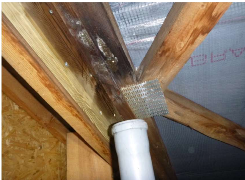
Fot. 7.15 Wskutek kolizji wywiewki kanalizacji z elementem konstrukcji, zakończono rurę pod elementem drewnianym, czego efektem jest widoczna na zdjęciu korozja biologiczna elementu drewnianego (fot. U. Kotwica)
