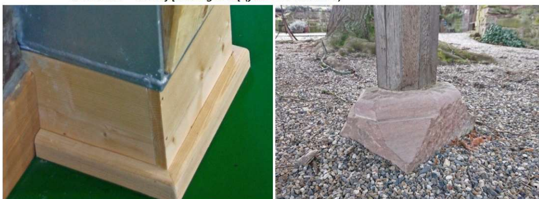
Fot. 7.26 TAK. Wykonstruowując odpowiednio podporę można oddalić konstrukcyjny element drewniany od podłoża, zapobiegając tym samym jego zawilgoceniu. Po lewej stronie podstawę słupa odsunięto od podłoża, obudowując element fundamentu żelbetowego drewnem. Zdjęcie po prawej stronie pokazuje, że wiedzę tę posiadali już dawni mistrzowie budowlani (fot. E. I. Kotwica)
