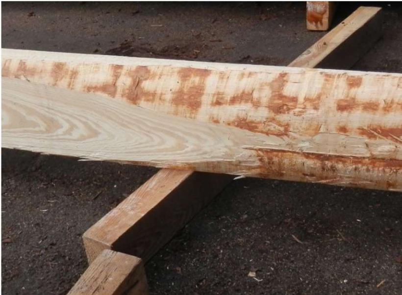
Fot. 7.6 Element z drewna litego, który nie nadaje się do zastosowania konstrukcyjnego (fot. E. I. Kotwica)
