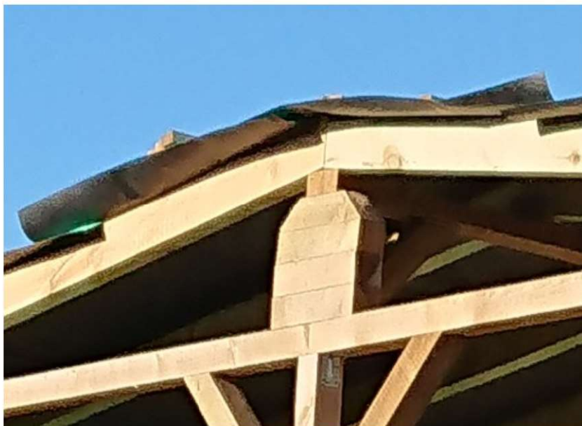
Fot.7.9 Detal więzara wykonany według fantazji wykonawcy. Praca i bezpieczeństwo takiego rozwiązania są co najmniej dyskusyjne. (fot. E.I. Kotwica)
