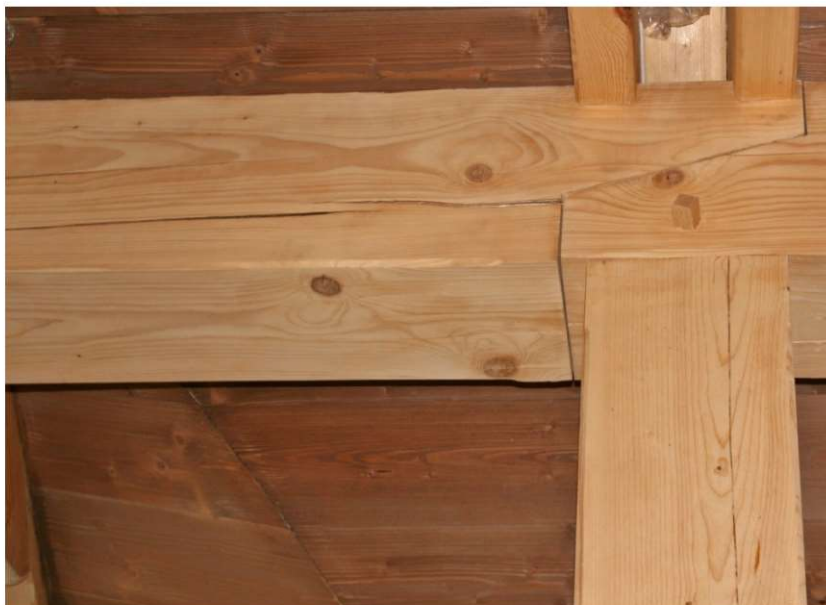
Fot. 7.11 Zastosowanie drewna nie przeznaczonego do celów konstrukcyjnych w połączeniu z przyjętym rozwiązaniem (nie wiadomo, czy przez projektanta, czy „pomysłowego” wykonawcę) zaskutkowało spękaniem i brakiem pracy części odspojonej. Niezbędne wzmocnienie. (fot. E. I. Kotwica)
