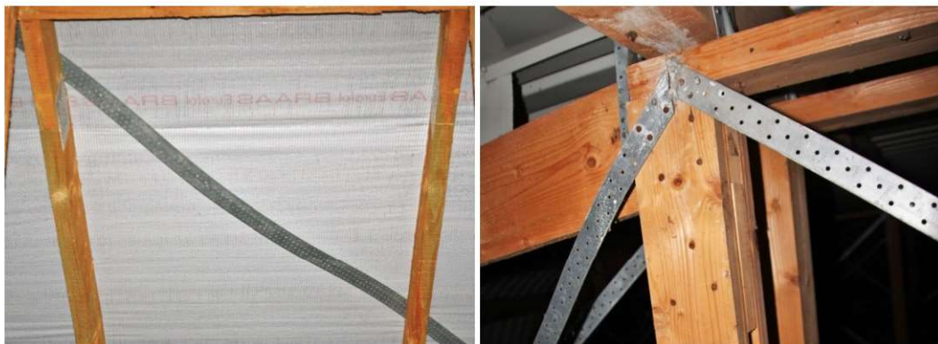
Fot. 7.19 NIE. Przypadkowe wykonanie stężeń z zastosowaniem taśmy perforowanej. Po lewej stronie wyraźne obwiśnięcie taśmy, co powoduje, że nie spełnia żadnej roli jako stężenie, po prawej stronie przypadkowe, niczego nie gwarantujące zamocowanie taśmy na elemencie drewnianym (fot. E. I. Kotwica)
