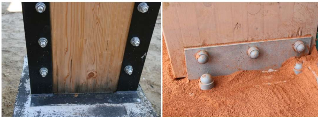
Fot. 7.25 NIE. Niepoprawne wykonanie i wykonanie podpór słupów. Usytuowanie drewna w bezpośrednim sąsiedztwie wilgotnego podłoża skutkuje podciąganiem kapilarnym wody, a docelowo – korozją biologiczną (fot. E. I. Kotwica)
