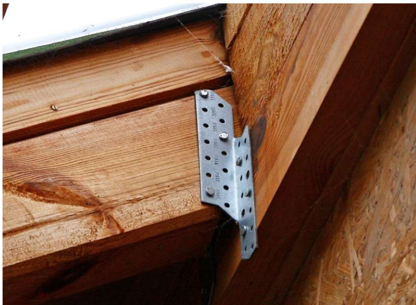
Fot. 7.23 NIE. Niepoprawne, przypadkowe zamocowanie tącznika krokwiowego (fot. E. I. Kotwica)
