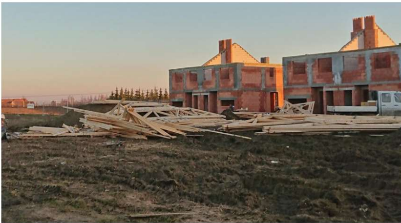
Fot. 7.8 Niepoprawny sposób składowania więzarów kratowych i drewna – elementy konstrukcyjne leżą w sposób przypadkowy, w bezpośrednim kontakcie z gruntem. (fot. E.I. Kotwica)
