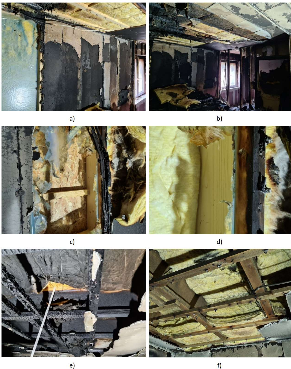
Fot. 6.21. Scenariusz pożarowy P1 i P3 – widok pomieszczenia po pożarze: a) ściana z odsłoniętymi kolejnymi warstwami, b) strop z odsłoniętymi kolejnymi warstwami, c i d) – widok odsłoniętej, nienaruszonej konstrukcji drewnianej ściany szkieletowej, e i f) – widok odsłoniętej, częściowo nienaruszonej konstrukcji drewnianej stropu. (fot. P. Sulik)
